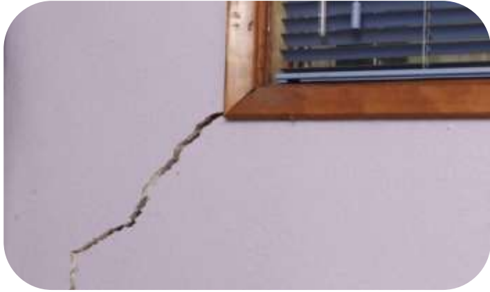
Dommmages sur nos infrastructures
